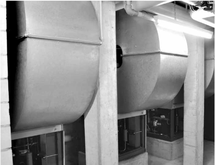
Die 1994 eingebauten Wärmepumpen, welche die Luft aus der Tiefgarage der Ulmenstrasse 28 nutzen, wurden 2017 überholt.
