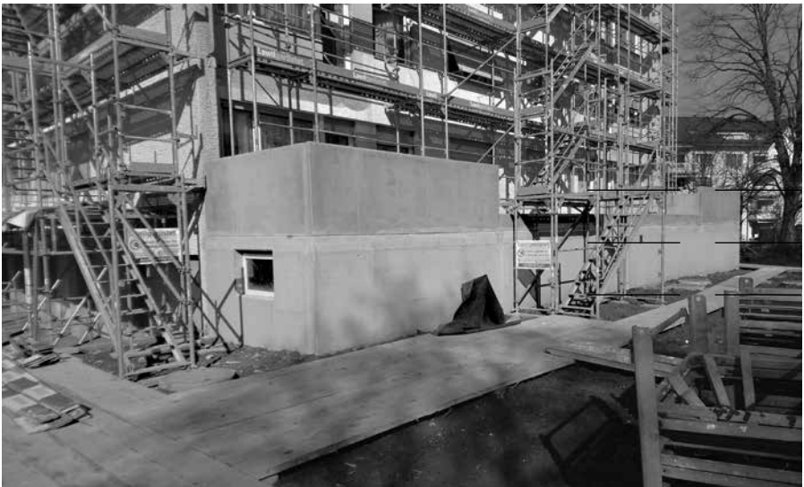
Der Anbau an der Südfassade des Gärtnerwegs 6 mit den daraufliegenden Balkonen konnte noch 2017 realisiert werden. Im Frühjahr 2018 begann die Fassaden- und Strangsamierung.
